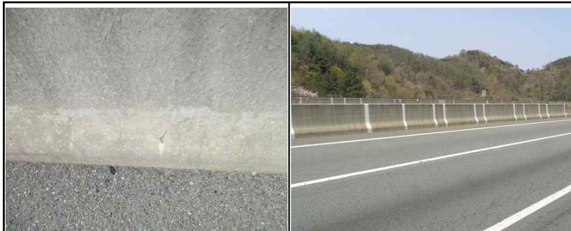
하행선 S7 균열
