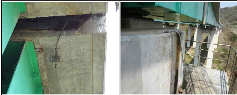
상행선 P7 유도배수관 배수관 탈락
